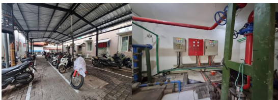
Gambar 4. Lokasi Tangki Septik di Bawah Area Parkir (Kiri) dan Pompa Air (Kanan) yang Melayani Beberapa Blok Sekaligus Sumber: Dokumentasi Penulis 2024
