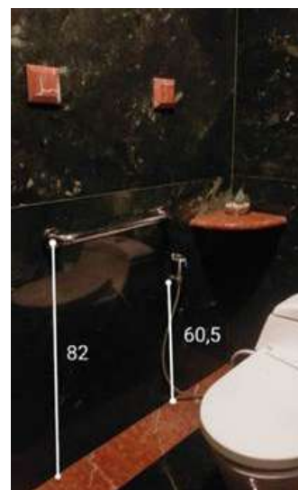
Gambar 17. Fasilitas Toilet Difabel
