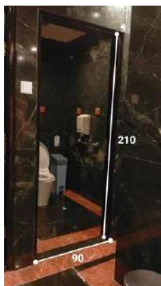
Gambar 18. Lebar Pintu Masuk Toilet Difabel Sumber: Dokumen Pribadi, 2025
